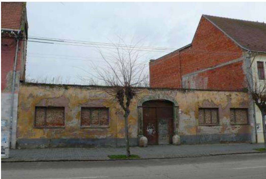
Štefánikova ulica 33 - priečelie zanikajúceho domu
