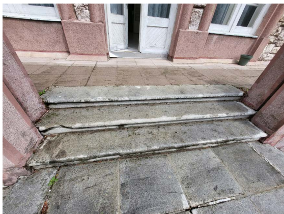
► Obr. 37. Vonkajšie schodisko, stav schodiska je v dôsledku absentujúcej údržby narušený, lovecký zámoček, Prašice.
