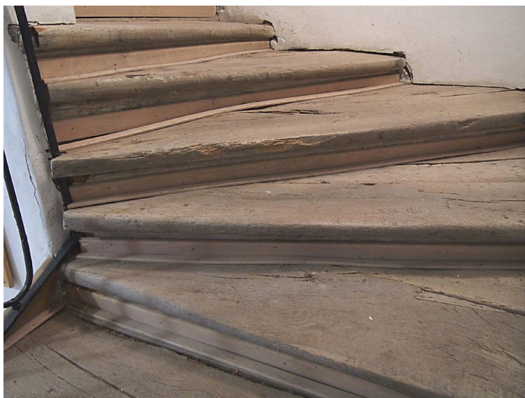
► Obr. 41. Meštiansky dom, Banská Štiavnica. Príklad nevhodnej opravy historického dreveného schodiska. Poškodené časti schodiska boli prekryté novodobými lištami, ktoré narušujú pamiatkovú hodnotu schodiska a celistvosť jeho výrazu.
