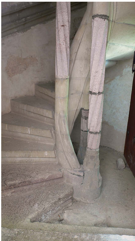
► Obr. 29. Historické kruhové kamenné vretenové schodisko, kde bola zrealizovaná radikálna obnova výmenou historických prvkov s uplatnením kameňa z inej lokality, Starý zámok, Banská Štiavnica.
