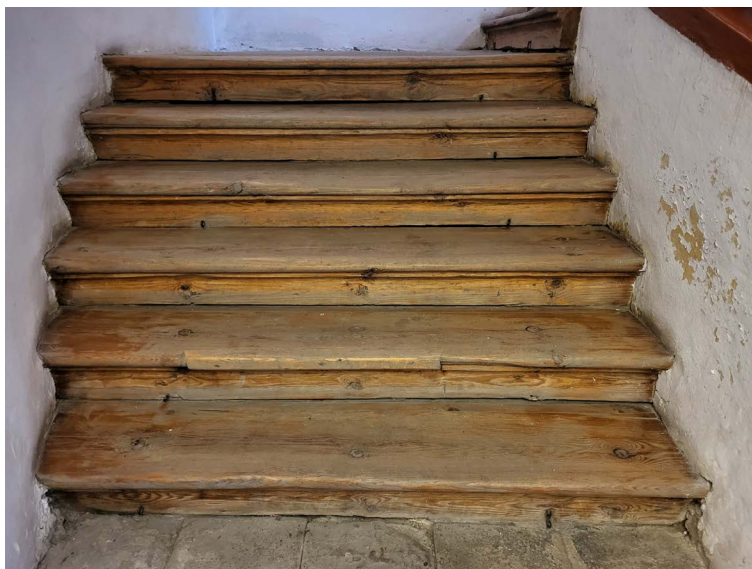
► Obr. 40. Meštiansky dom, Levoča. Oprava odštiepenej časti dreveného stupňa nerešpektuje profiláciu pôvodného schodiskového stupňa.
